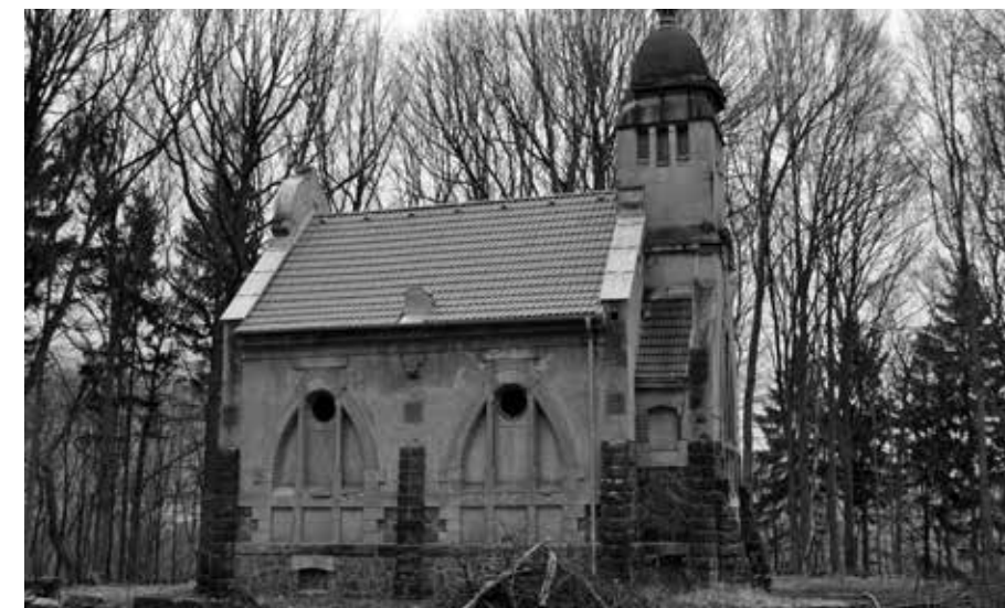
ÚSTECKÝ KRAJ PŘÍSPĚL NA OPRAVU POŠKOZENÉ KAPLE ČÁSTKOU 200 000 Kč.
