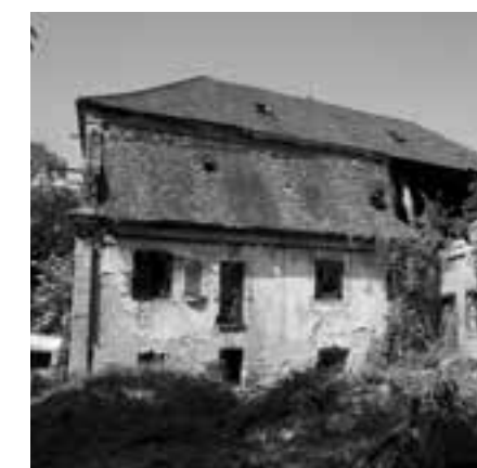
HAVARIJNÍ STAV MLÝNICE VE VEPŘKU
