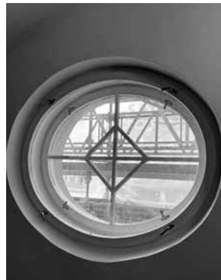
JEDNO Z MÁLA DOCHOVANÝCH PŮVODNÍCH OKEN (PO 2. SVĚTOVÉ VÁLCE) PO REPASI
